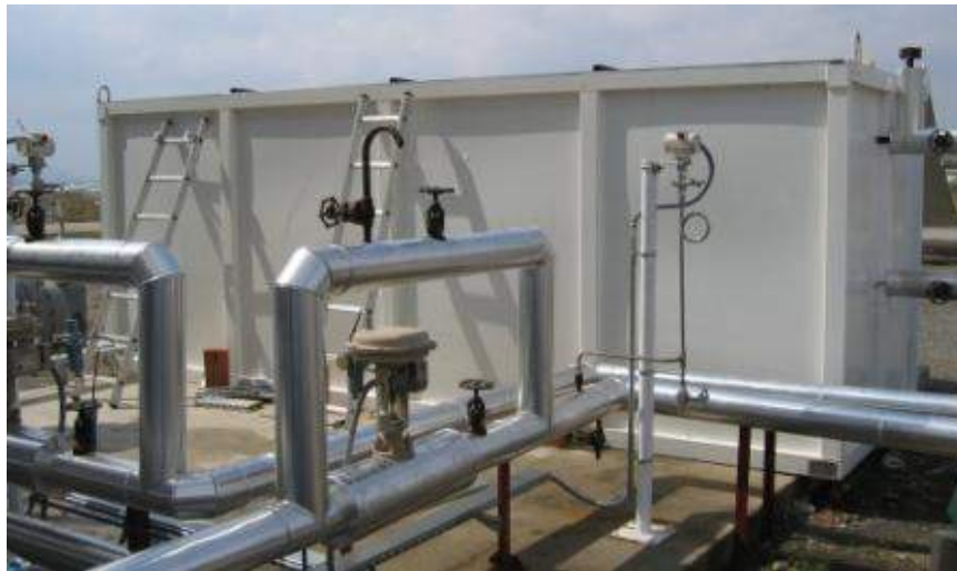
Testmodul 100kW, Beladung mit solar erzeugtem Dampf
