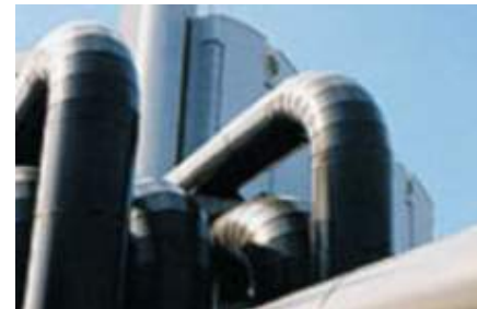
Fernwärme Ulm, www.rw-electronic.de
