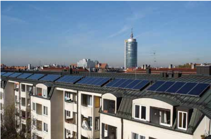
Solarthermische Anlage auf Wohnblock
