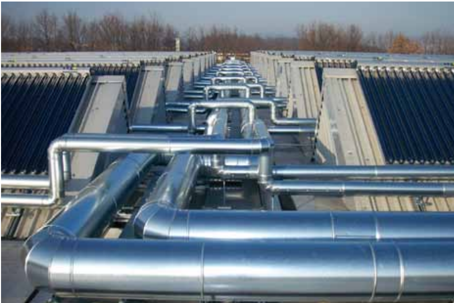
Dachansicht solare Kühlanlage mit 1.300 m 2 Kollektorfläche in Esslingen
