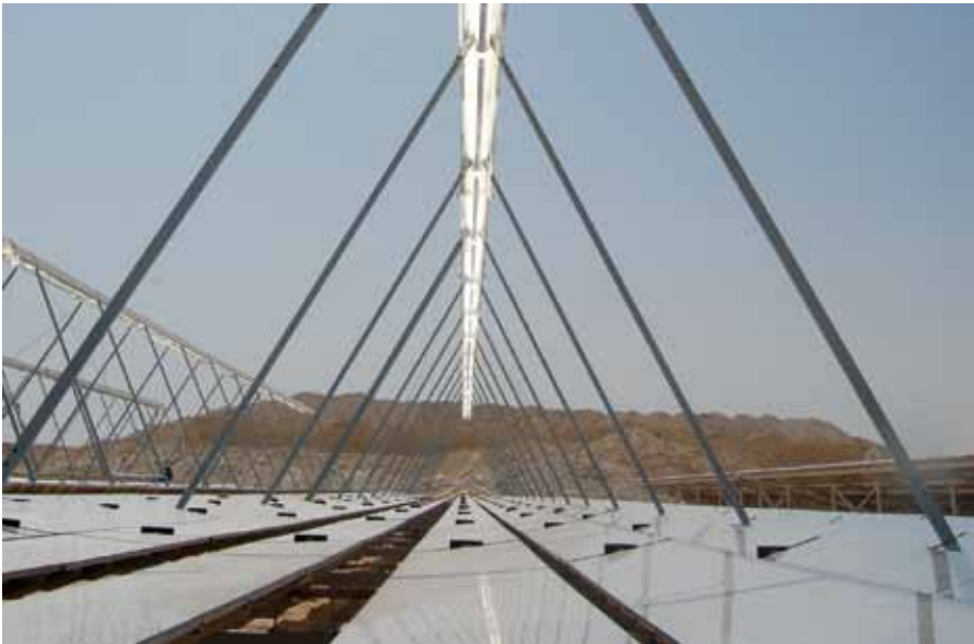
Fresnel-Kollektor zur Prozesswärmeerzeugung von 180 °C
