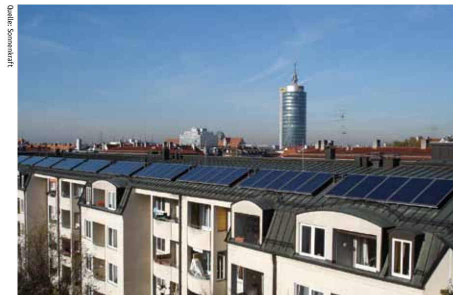
Solarthermische Anlage auf Wohnblock
